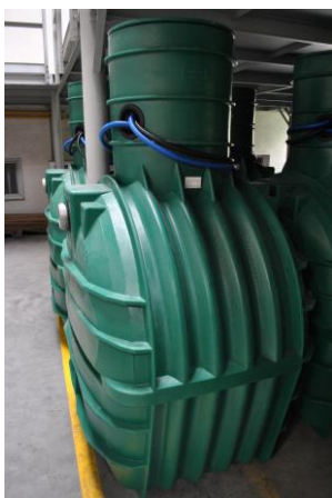
ČOV EČ - SBR-2
